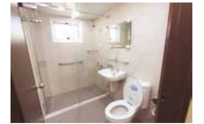
▲乾濕分離浴室設備
